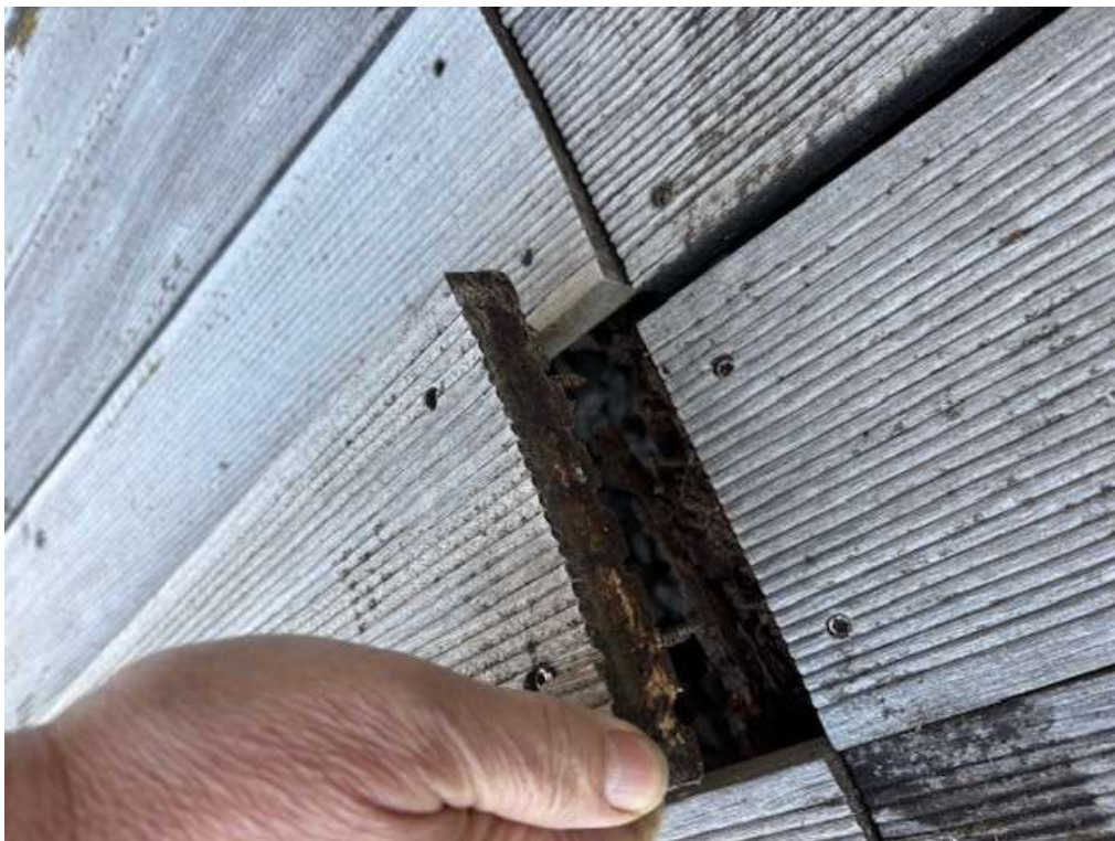
Beschädigung Holzunterkonstruktion und Dielung
