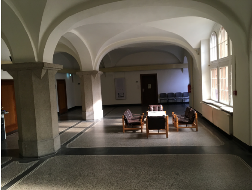
Foto: Treppenraum 7 mit unzulässigen Brandlasten
