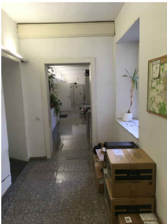
Foto: unzulässige brennbare Verkleidungen und unzulässige Installationen im notwendigen Flur.
